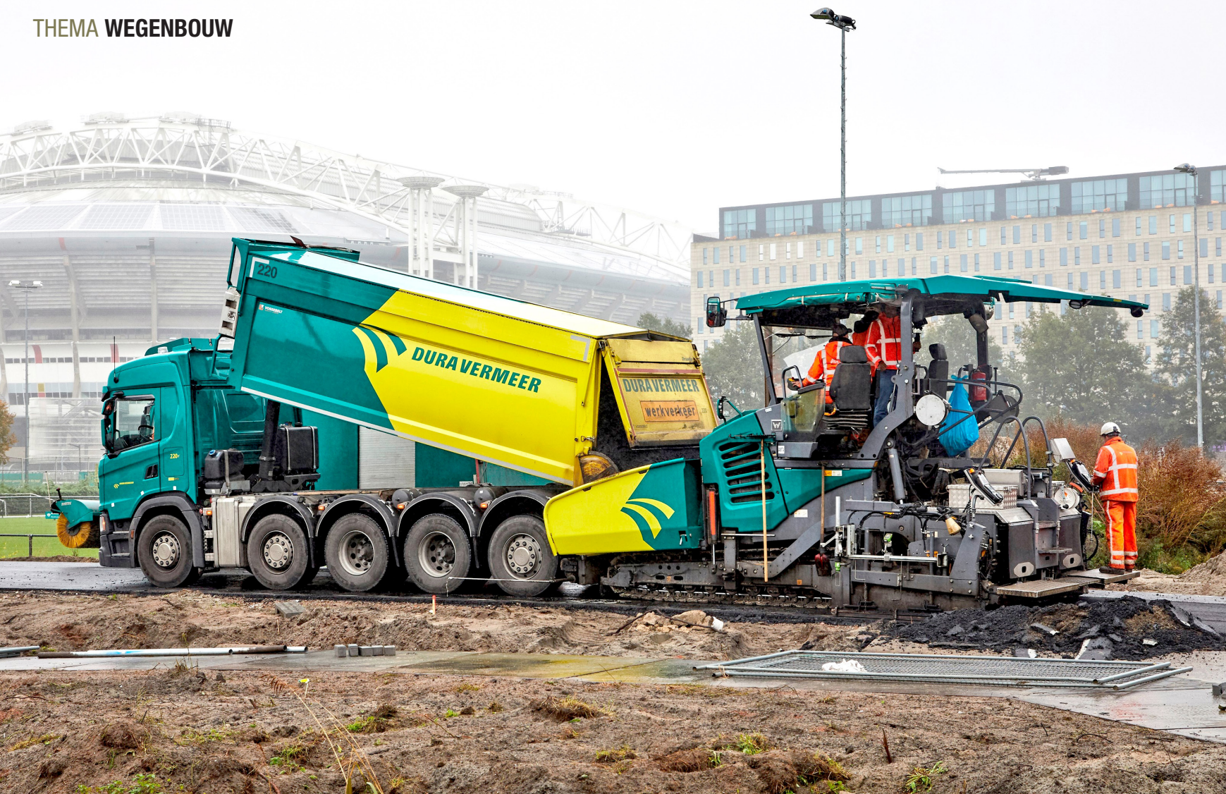
De 100% circulaire deklaag voor een nieuwe weg in Amsterdam is een wereldprimeur.
